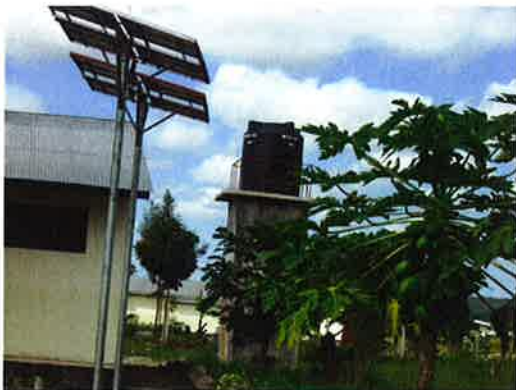
Solarpumpen verteilen Wasser effizient und zuverlässig. (Foto: Plan Tansania)
